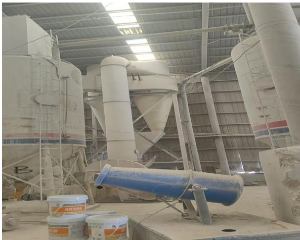
图 3-4 废气处理设施（喷雾设备）
