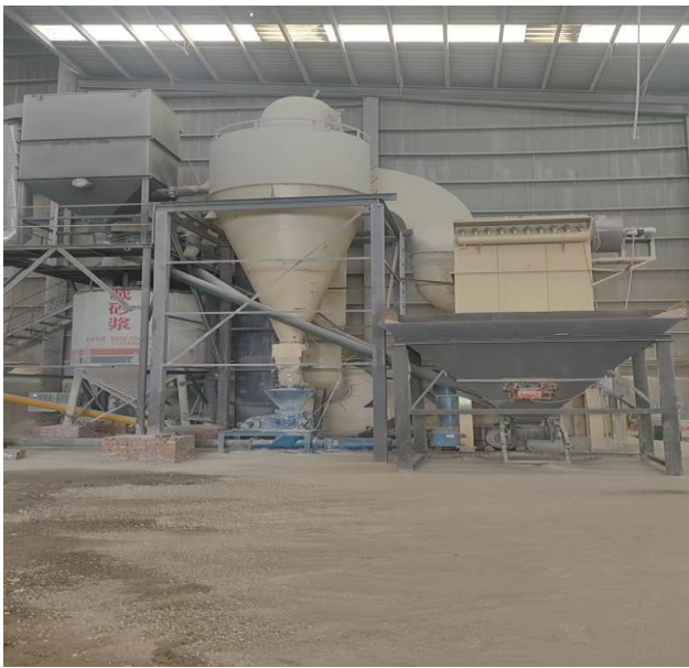
图 3-5 废气处理设施(袋式除尘器)
