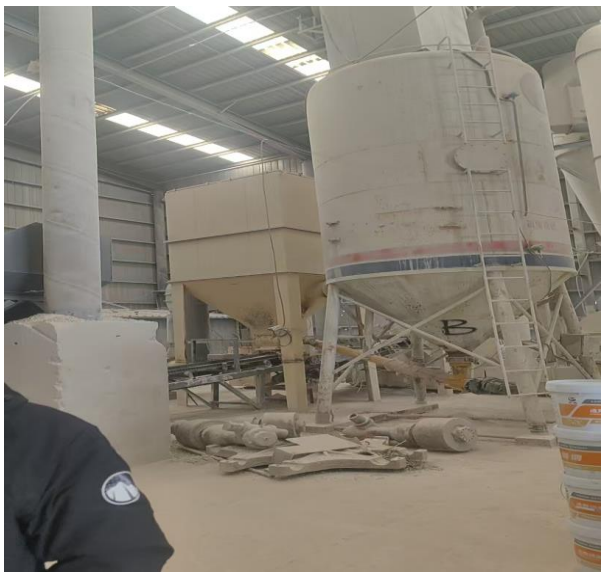
图 3-6 废气处理设施(袋式除尘器)
